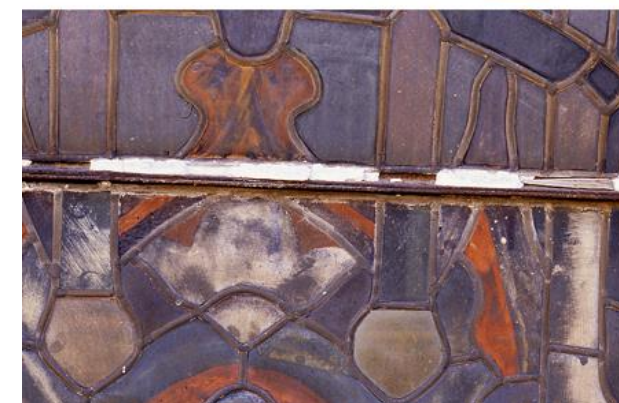
Fig. 8. Sulfatación y carbonatación de la masilla de montaje, resultando en deshidratación, cuarteamiento y pérdida de materia. Fotos: Fernando Cortés Pizano.
