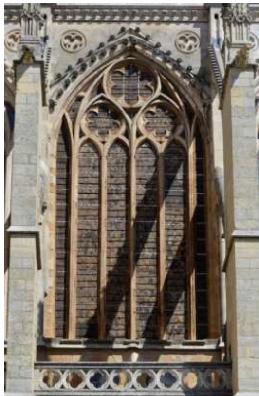
Fig. 1. Fotografía del ventanal S-XIV antes de su restauración (2024). Foto: Jorge Díez García-Olalla.
