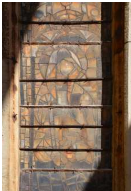
Fig. 10. Paneles del ventanal S-XV en el que se aprecian capas de suciedad adheridas sobre los vidrios (2019). Foto: Mariano Diez Sáenz de Miera.
