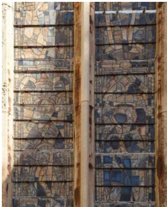
Fig. 7. Fotografía de varios paneles del ventanal S-XIV antes de su intervención, donde se observa el estado avanzado de oxidación que presentaban las barras de rigidización, los perfiles en «T» y las chavetas (2024). Foto: Jorge Diez García-Olalla.
