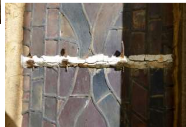
Fig. 6. Estado en el que se encontraba la masilla que sellaba la unión de dos paneles a los perfiles en «T» del ventanal S-XV antes de su intervención (2022). Foto: Jorge Díez García-Olalla.
