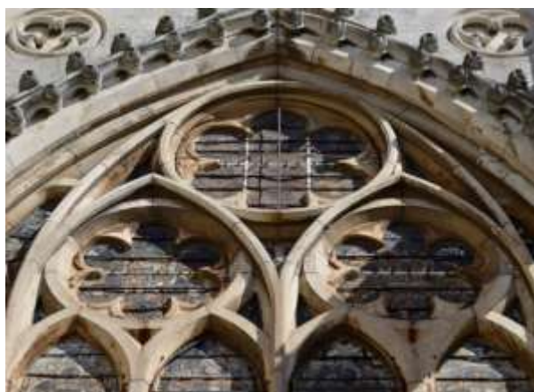
Fig. 5. Rosas del ventanal S-XIV antes de su intervención en el que se aprecian las pátinas de oxidación ocasionadas por las mallas de protección, existiendo todavía restos en la rosa superior (2024). Foto: Jorge Díez García-Olalla.
