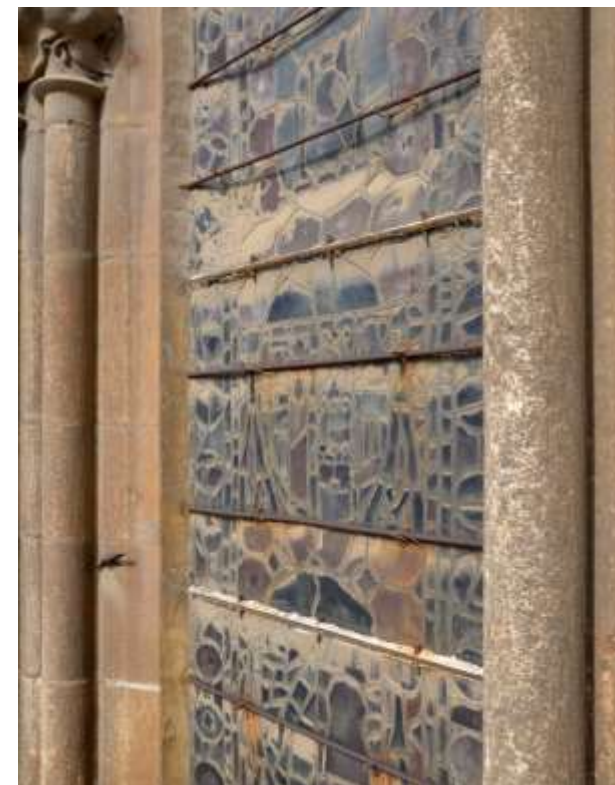
Fig. 8. Paneles de vidrieras de un ventanal del nivel del triforio del hastial sur, donde se aprecia la deformación experimentada por el panel superior debido a las dilataciones que sufren (2024). Foto: Jorge Diez García-Olalla.
