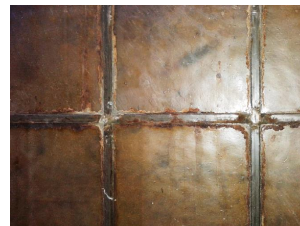
Fig. 12. Abundantes restos de aceite de linaza sobre los vidrios de una vidriera, fruto de una insuficiente limpieza del panel y de su montaje antes del secado completo de la masilla. Foto: Fernando Cortés Pizano.
