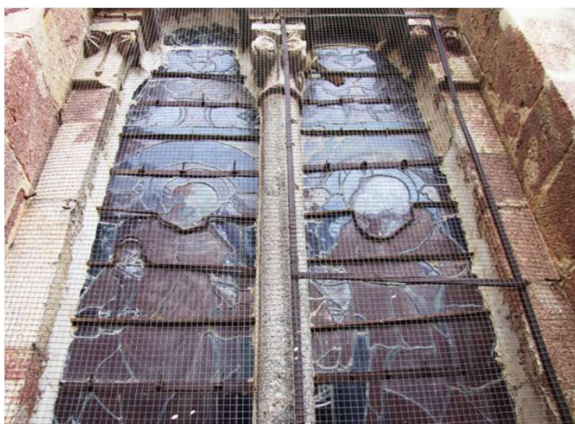
Fig. 13. Vidriera del siglo XV, presbiterio de la catedral de Ávila. El rejuntado de los paneles se ha realizado de forma muy poco cuidadosa, creando una cuña excesivamente gruesa y que desfigura las formas de la arquitectura y de la vidriera. Imagen: Fernando Cortés Pizano.
